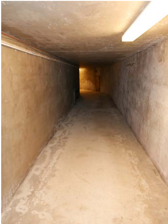
"Rum" 114 utgör tilluftskanal.
