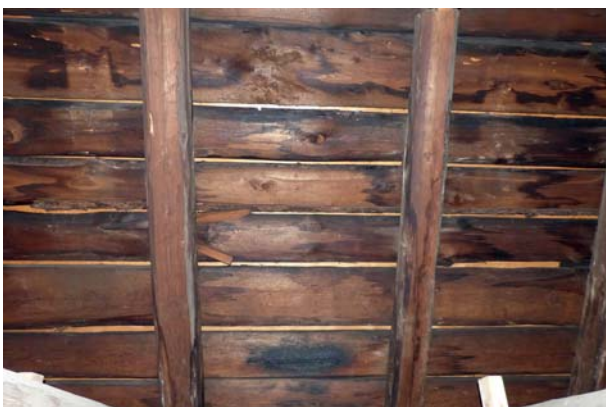
På innertaket finns spår av äldre fuktskador.
