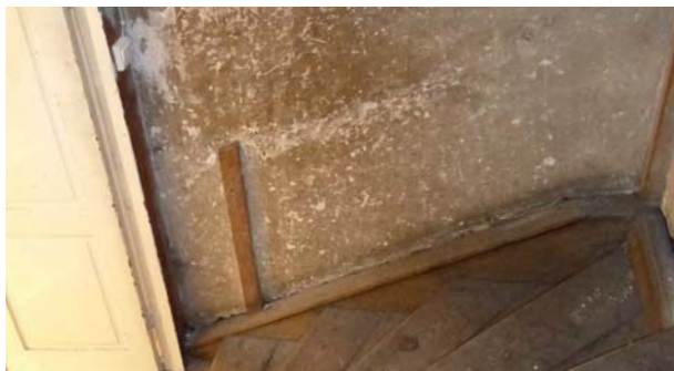
I trappan upp till vinden finns äldre putsskikt med spår av bemålning bevarade.
