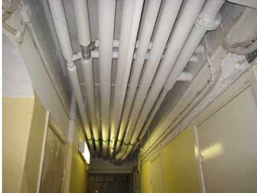
Rörstråk i källarkorridor.
