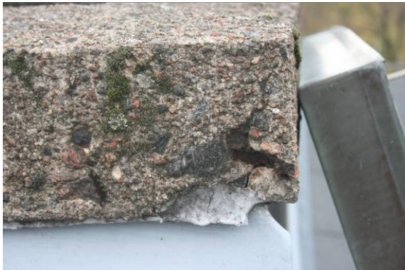
Skada i krans.
