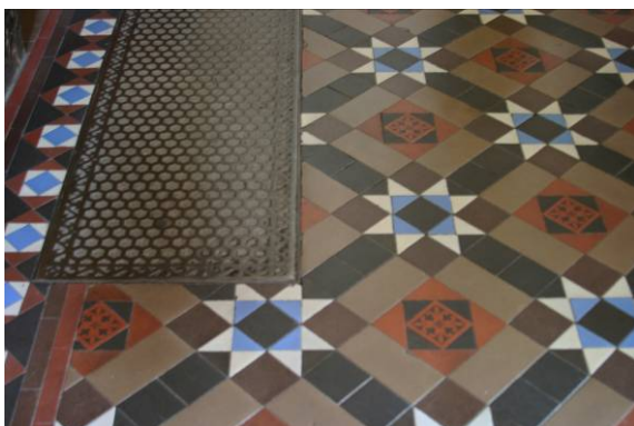
Keramikgolv och igensatt galler.
