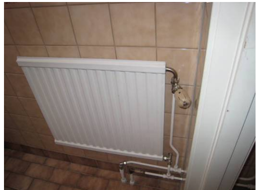
Panelradiator, antagligen installerad vid renovering på 70-talet.
