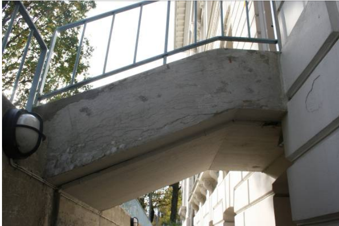
Entrétrappa mot parkgatan med skador i vangel.
