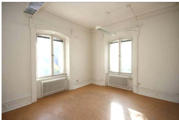
Originalfönster i rum 408. Vänster fönster är delvis igensatt.
