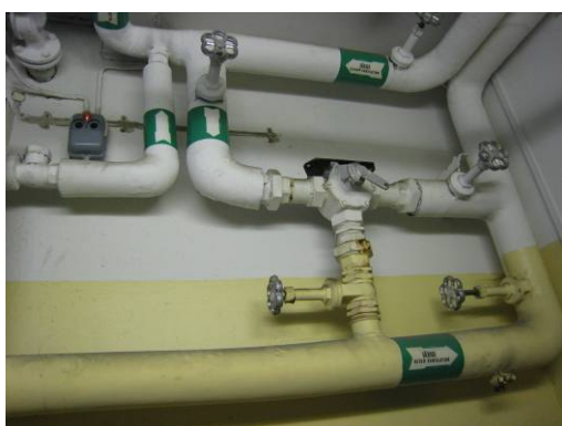
Ursprungligt shuntkoppel för TA3. Demonterat ställdon.
