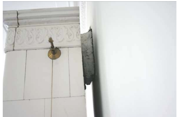
Det finns fogsläpp och sprickor i kakelugnarna.
