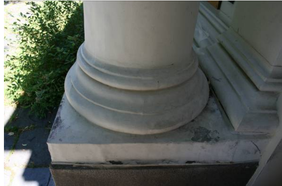
Förzinkad plåt med färgsläpp.
