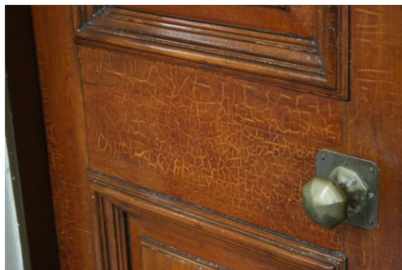
Dörrarna mot entréhallen har tjocka lager av lack.
