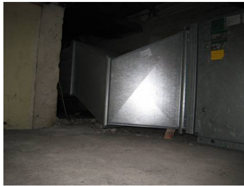
Ventilationskanal ovan kökets undertak.
