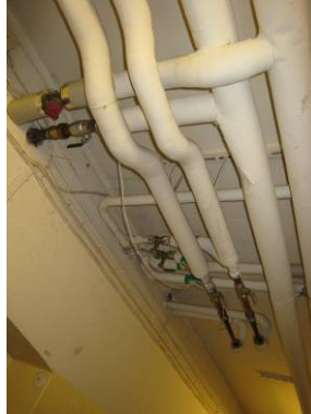
Asbest i böjar och isoleringsavslut.
