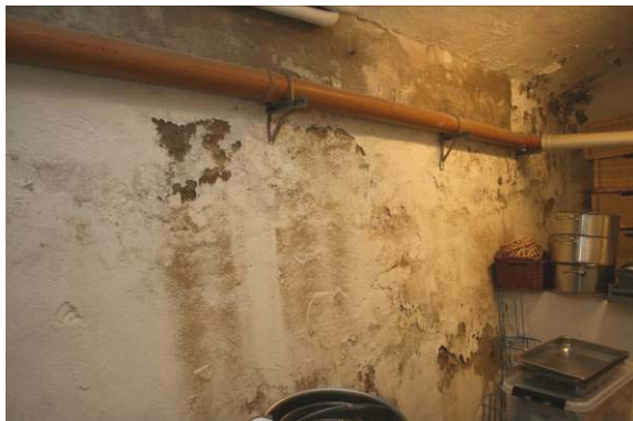
Fuktgenomslag i vägg mot väster.
