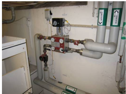
Shuntgrupp för radiatorsystem till gårdshus.
