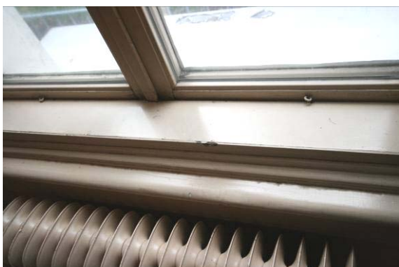
Fönsterkarm med liten träskada.
