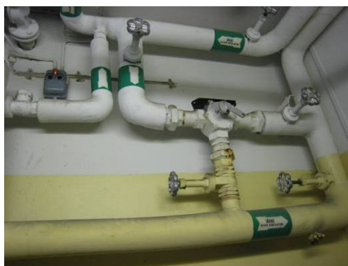
Ursprungliga ventiler finns fortfarande kvar i delar av systemet.
