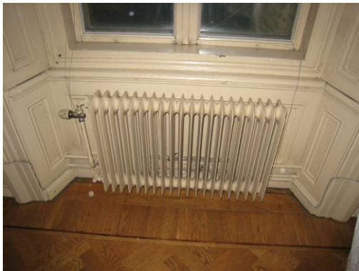
Sektionsradiator från ursprunglig installation.
