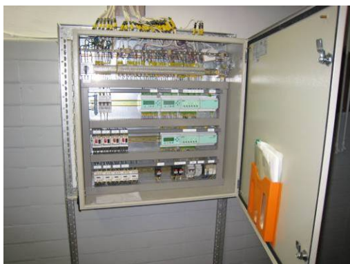
Apparatskåp i fjärrvärmecentralen.
