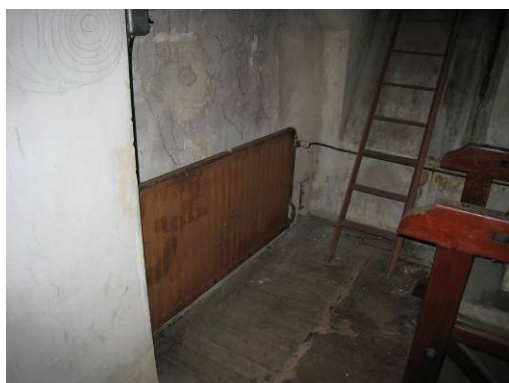
Rostig radiator på vindsplan.
