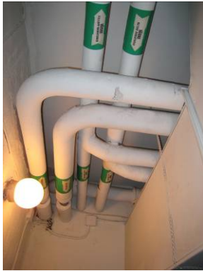
Ventilationskanal vid källartak.
