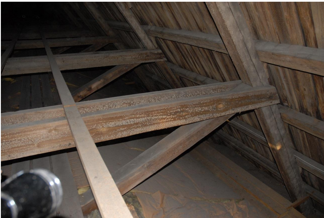
Betydande påväxt av mögel på konstruktionsvirke i takstol.
