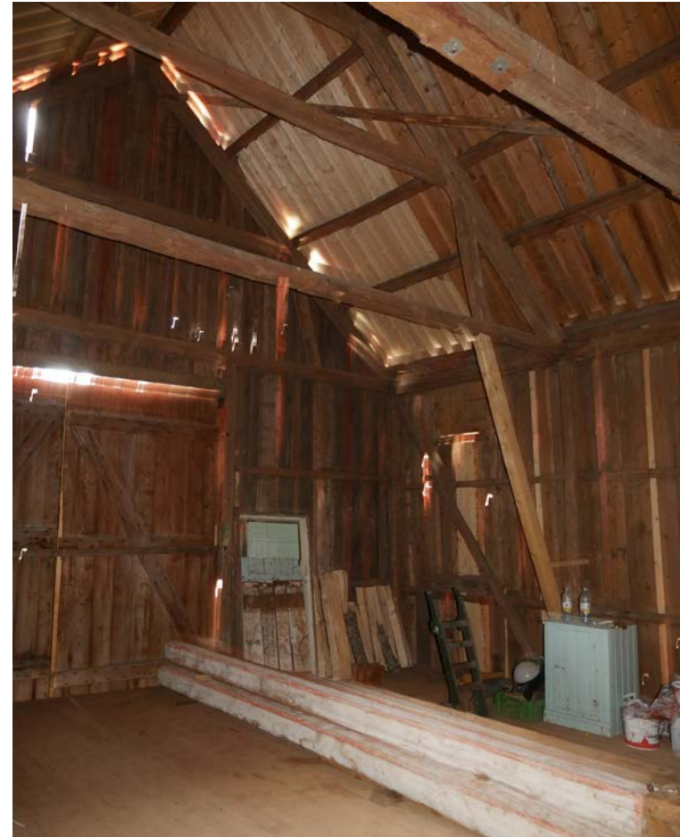
Lagningar i takinbrädningen mot norr samt komplettering av nya snedsträvor i rum 103. 2018-08-22
