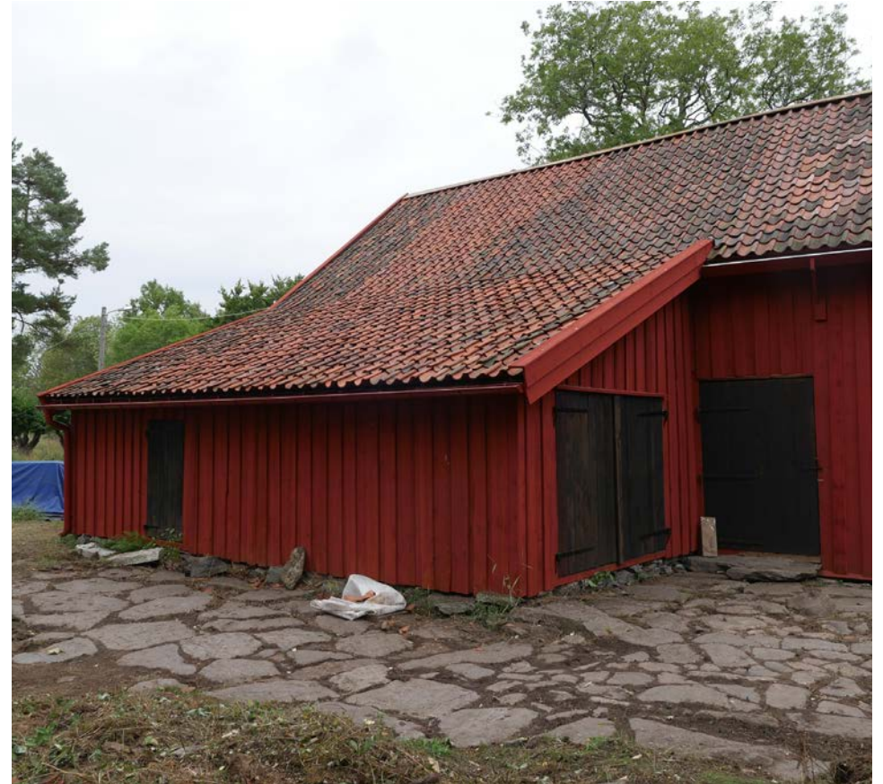
Efter avslutade arbeten med bl a återmonterad och målad panel, omläggning av tak och renoivering av portar. 20108-08-22
