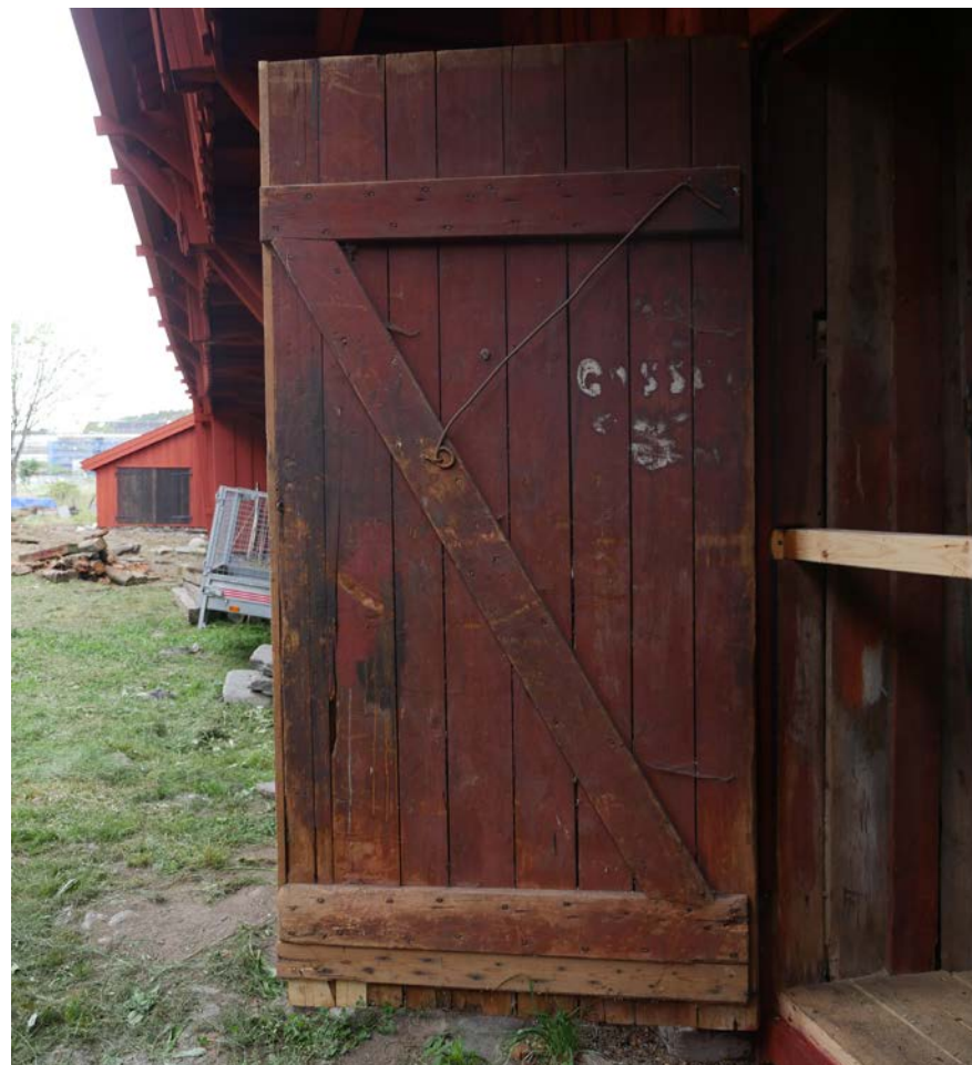
Äldre portar har renoverats sparsamt för bibehållen patina. Portar har strukits med tjära utvändigt men har inte målats invändigt. 2018-08-22
