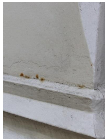
Rostfläckar i kolonnbasen.
