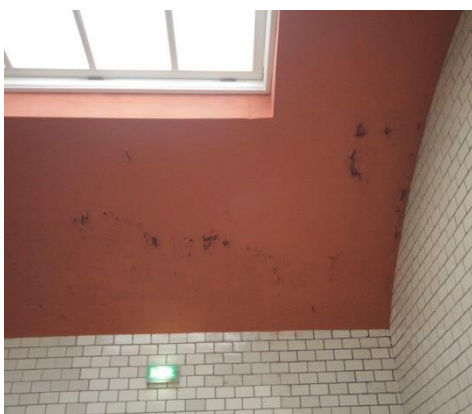
Välvt putsat och målat tak med färgsläpp.
