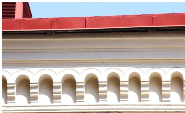
Murad putsad utkragande takfot med konsoler och valv. Sättningsprickor förekommer på flera ställen.
