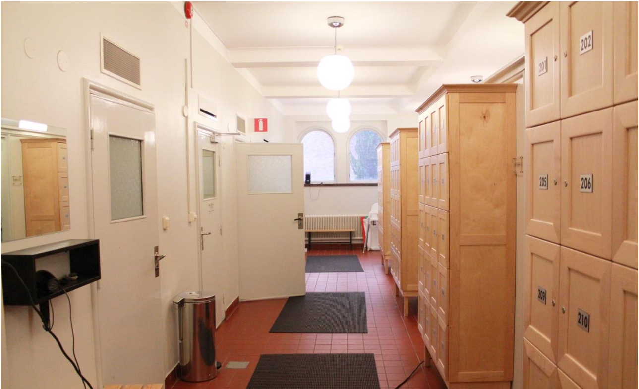
Omklädningsrum med klinkergolv, målade väggar och tak med synliga balkar. Väggen till vänster är äldre. Väggen till höger är senare tillkommen och ansluter inte mot golv och tak.
