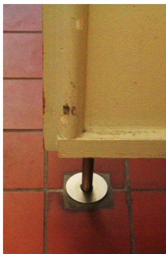
Lös vägg till höger i bild ovan.
