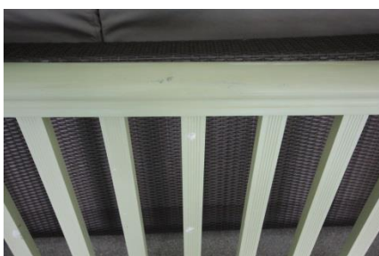
Färgsläpp i balustrad.
