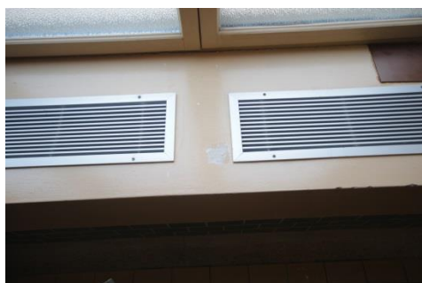
Fönsterbänk med färgsläpp.
