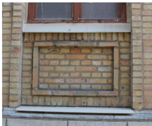
Bröstning vid ångbastu med fuktgenomslag mot väster.
