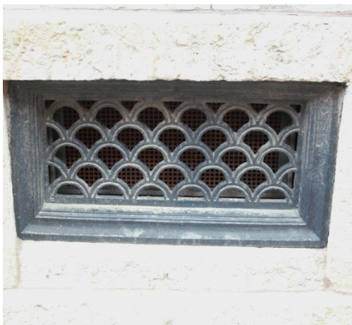
Gjutjärnsventil i sockel.
