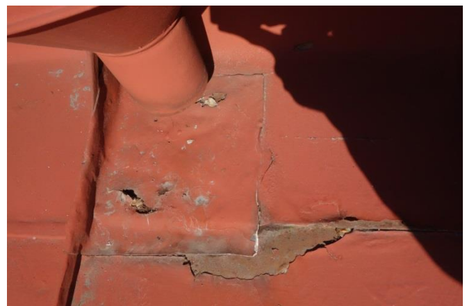
Färgsläpp, rostangrepp och delvis genomrostad plåt.
