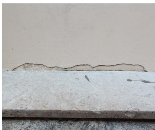
Putsskada i fönsterbröstning.
