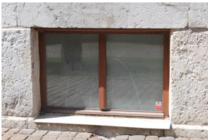
Källarfönster med lös spröjs.
