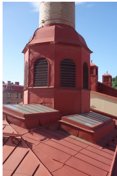
Plåtbeslagen åttkantig bas till skorsten.
