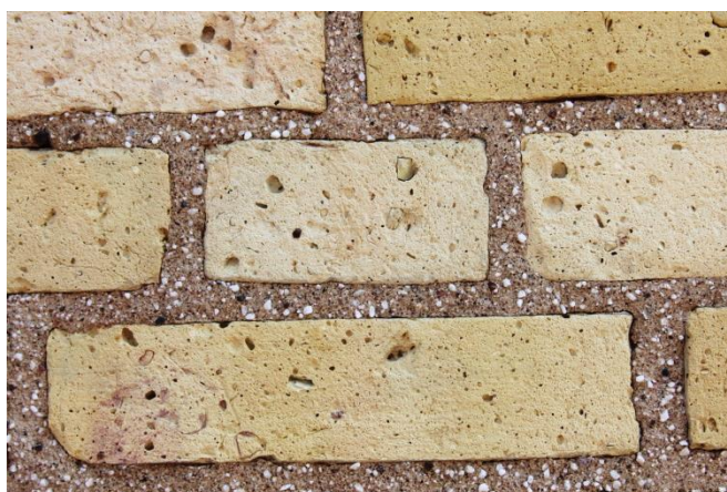
Skador i tegel och fog efter klottersanering. Ytan blir porös och suger lättare upp vatten.
