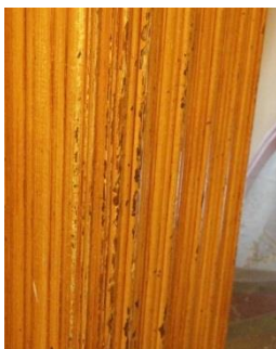
Slitage, färgsläpp i panel.
