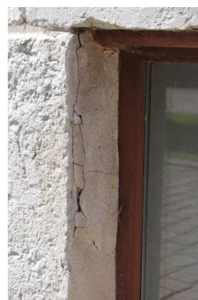
Putsad fönstersmyg med sprickor och putssläpp mot öster.
