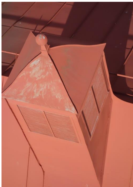
Färgsläpp på södra sidan av huv.
