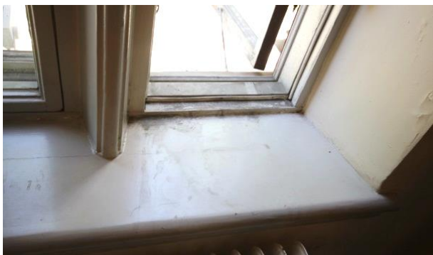
Sprickor och färgsläpp i fönsterbänk.
