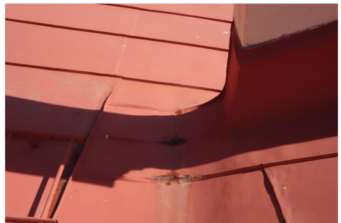
Färgsläpp och påbörjat rostangrepp.
