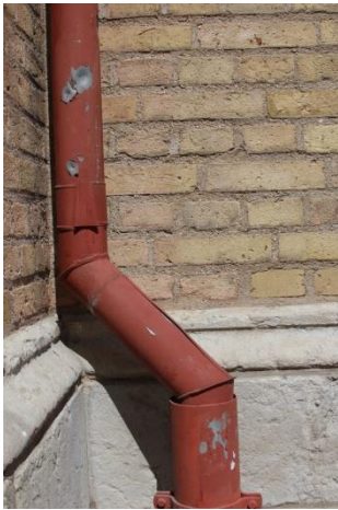
Stuprör med falsat knä.
