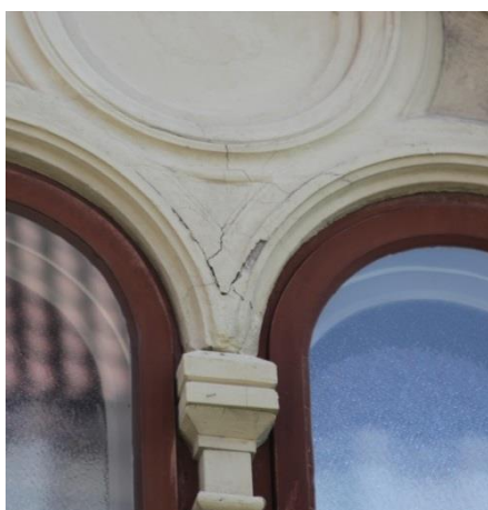
Putsskada i fönsteröverstycke.
