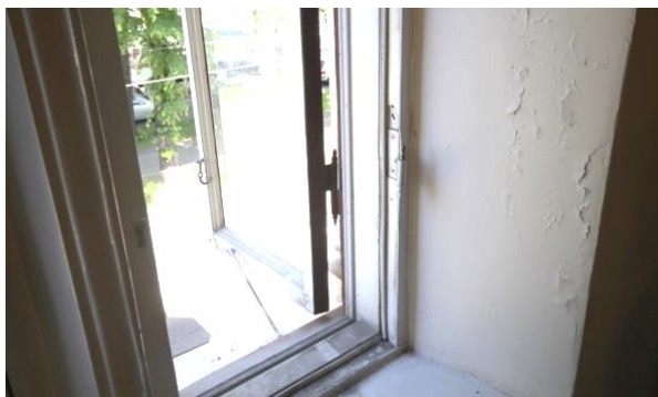
Sprickor och färgsläpp i fönsternisch.
