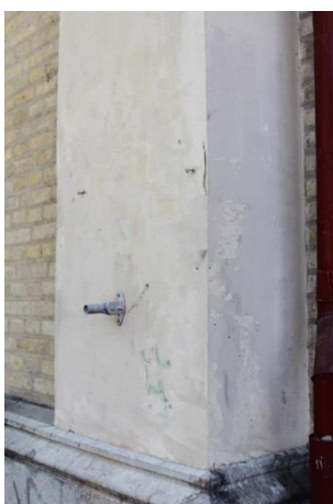
Putsat hörn med skador efter klottersanering.
